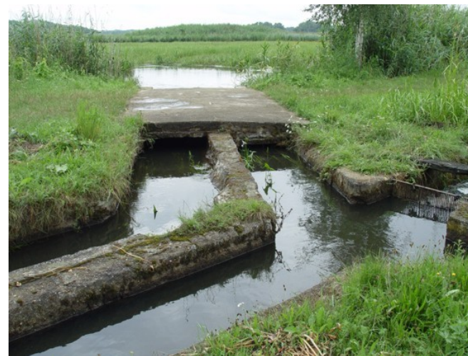
Urządzenia hydrotechniczne na stawie Niezgoda (KK)
